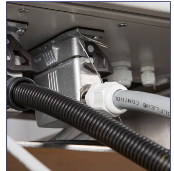
Pronto per Industry 4.0 e sensore che indica la rottura del tubo flessibile
